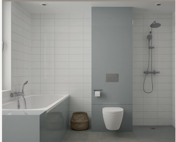
Bad met ombouw in badkamer
